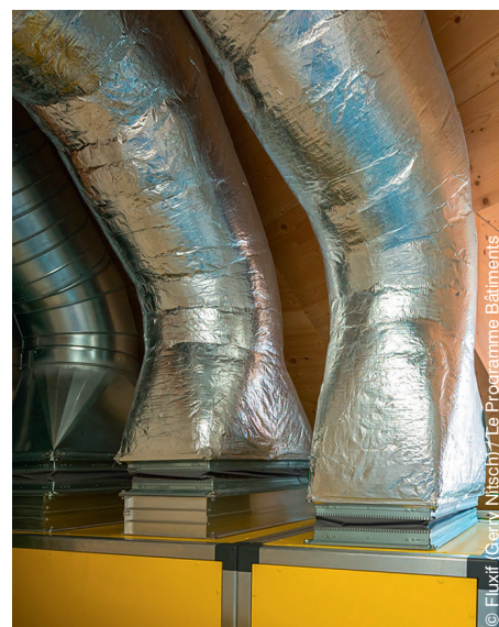
La ventilation contrôlée avec récupération de chaleur augmente l'efficacité énergétique des immeubles.
